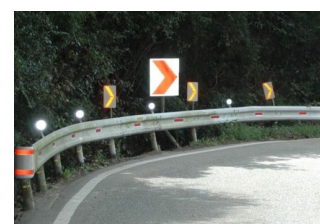
ふぞろいな視線誘導標が設置されている例
